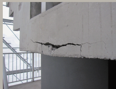
鉄筋が錆びて爆裂している様子。
